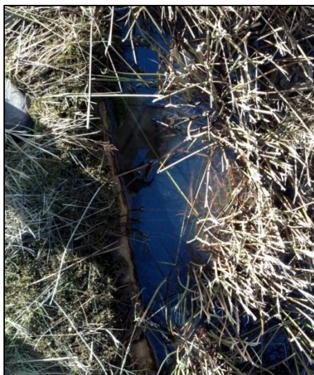
Figur 14. Starkt igenvuxet dike vid stentrumma (500x500 mm) under Marstrandsvägen öster om planområdet
