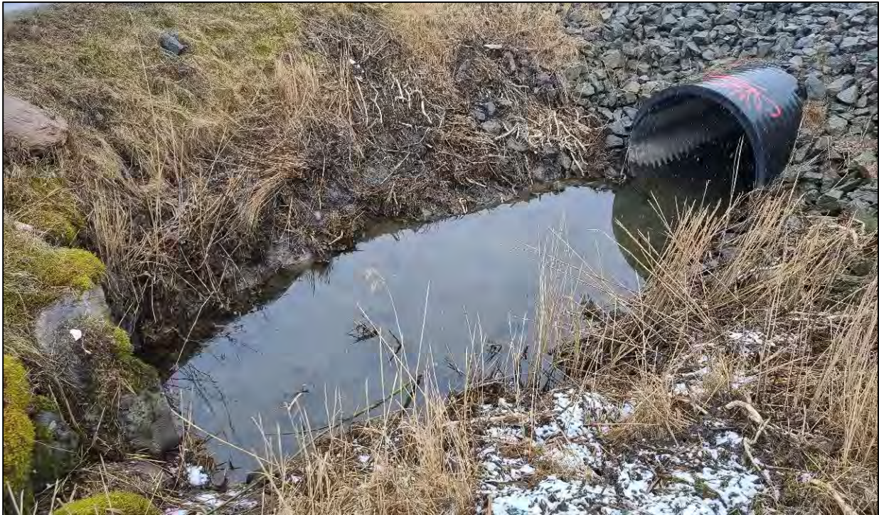
Figur 6-7 - Bild tagen vid trumma strax öster om Ytterbyvägen. Pågående erosion observeras i ytterkrön där växtlighet och jordmassor delvist har eroderats bort (Dec, 2022).
