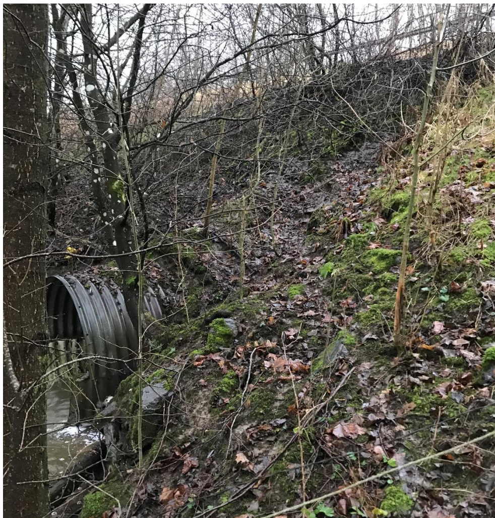
Figur 25. Kulvertering av Ormobäcken under Östergårdsgatan vid observationspunkt CW3 (COWI AB, 2019)
