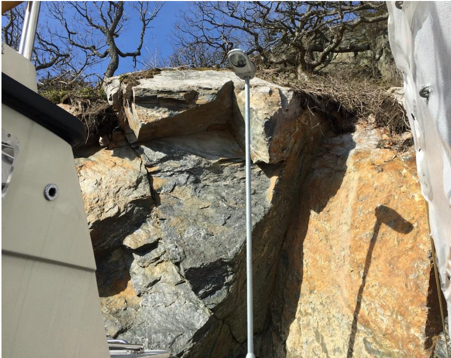
Figur 2-2 Potentiellt instabila block i skärningens sydvästra del.
