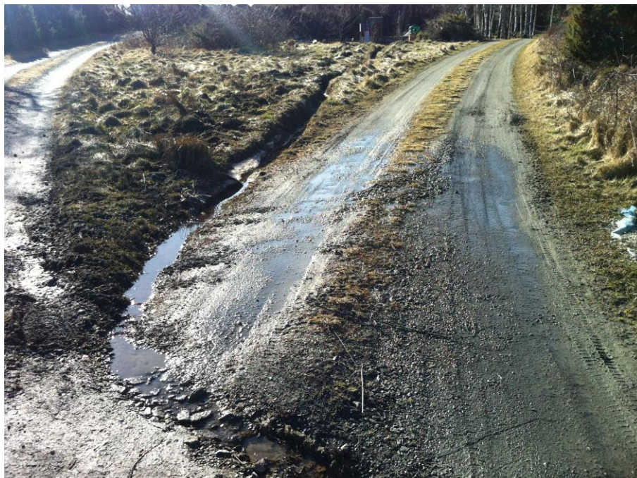
Figur 14. Avsaknad av vägtrumma leder till erosion av grusvägen
