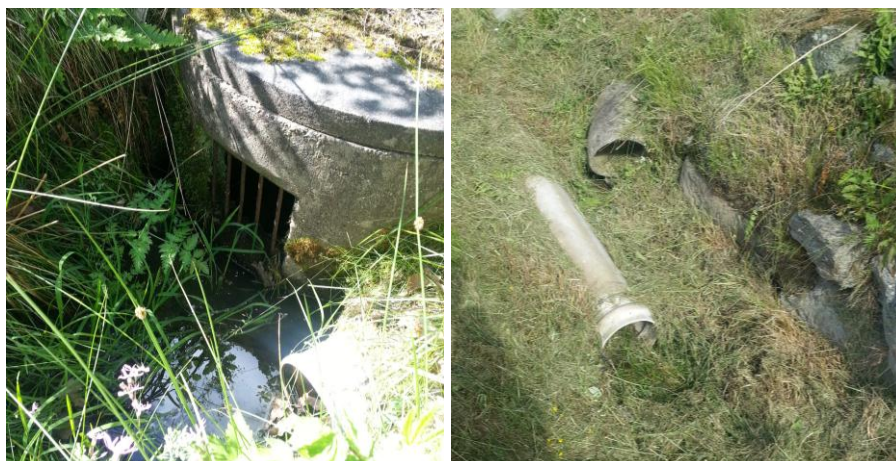
Figur 23. Till vänster: betongbrunn med inlopp från dike samt lös plasttrumma. Höger: Förmodat utlopp från betongbrunnen samt en trumma från annan betongbrunn där plasttrumman förmodas anslutas.
