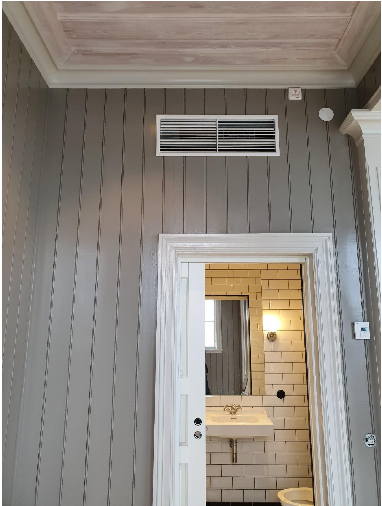
Vägg mot badrum med ventilationsgaller.
