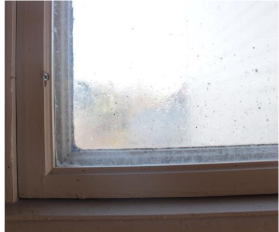
Senare kompletterat innanfönster med kraftig kondens och påväxt. Fönsterbågen är fastskruvad i karmen med stjärnskruv.
