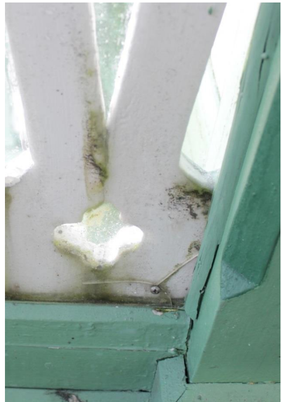
Kondens och påväxt av alger på insidan av plastskivan.
