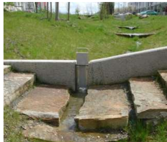
EXEMPEL PÅ DAGVATTENDIKE MED FÖRDRÖJNING. FOTO: NORCONSULT.
