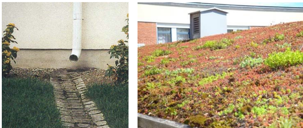
Figur 33 Exempel på utkastare med rännal och ett grönt tak
