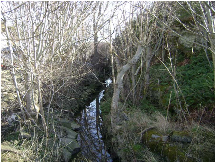
Figur 12. Utloppsdelen av huvuddiket mot utloppet i småbåtshamnen
