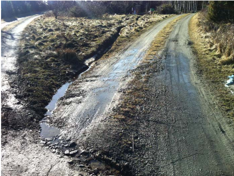
Figur 16. Avsaknad av vägtrumma leder till erosion av grusvägen
