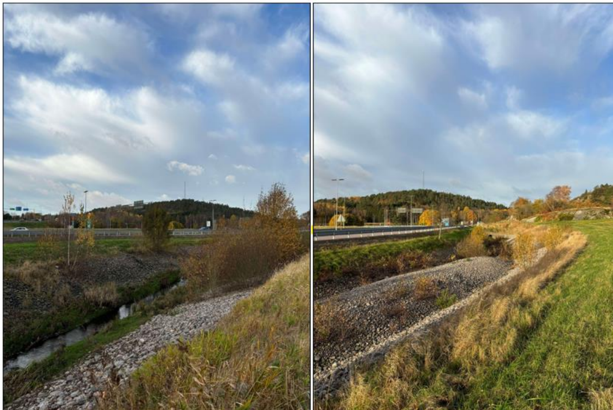
Figur 7-3 – Översiktsbild av diket längs E6:an med erosionsskydd.
