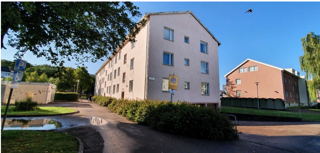
Lamellhuset på bilden är i dåligt skick på grund av sättningar och kommer troligen behöva rivas. Huset till höger i bilden kan troligen bevaras.
