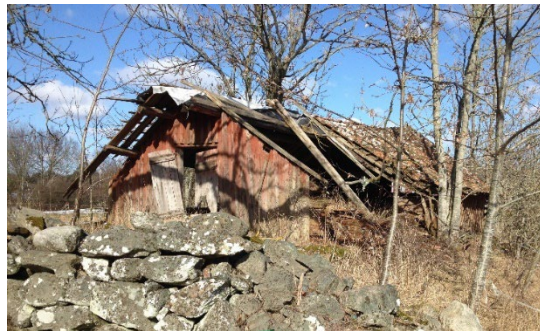
Bild 15. Källarvind, har i gällande detaljplan ingen byggrätt och är i mycket fallfärdigt skick.
