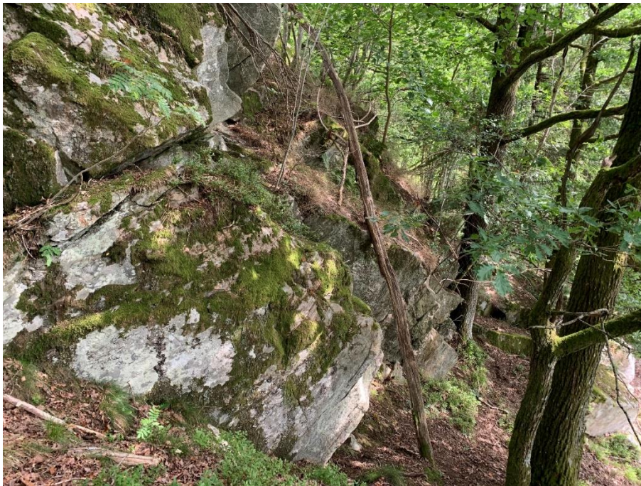
Figur 4.6. Blockigt-skivigt uppsprucken bergslänt med överhäng och utfallna block i släntfot. Blocken är stabila idag men kan undermineras vid schakt under dem. Bild tagen mot norr nära Olsebacken 12 (utanför bildens högra sida).
