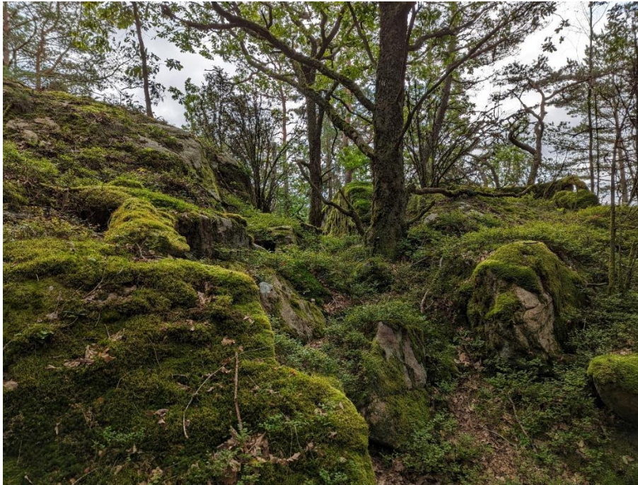
Figur 4.4. Mindre ravin vid bergsbrant, med blockig uppsprickning och utfallna block. Blocken är stabila idag men kan undermineras vid schakt under dem. Exempelbild från den södra bergsbranten.
