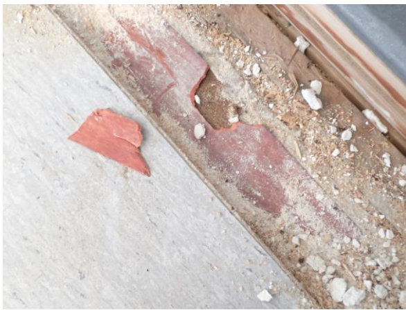
Figur 18. Äldre röd PVC-matta under nyare PVC och tjock spånskiva i By 5 (loftgången) innehåller asbest, enligt analys.
