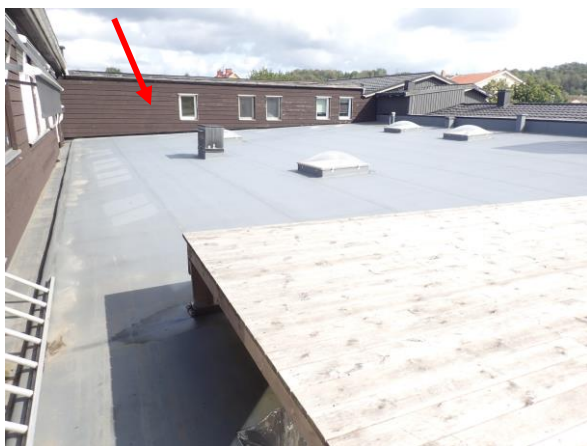
Figur 8. By 5 loftgång, internit innehållande asbest bakom träfasaden.
