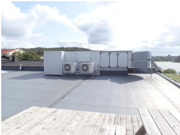
Figur 24. Aggregat på taken By 1 och By 6 är nyare.
