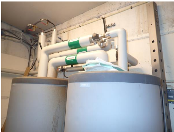
Figur 22. Rör till nyare varmvattenberedare är nyare. Inga äldre rör har påträffats.
