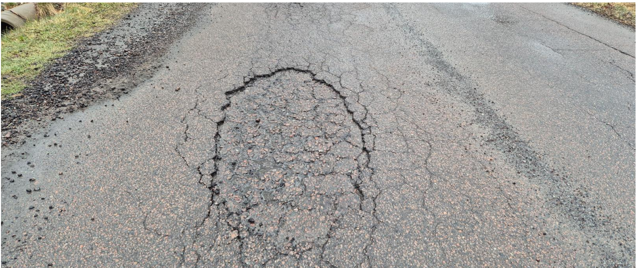
Figur 12. Skada i asfalt.
