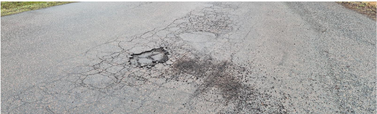
Figur 11. Skada i asfalt.
