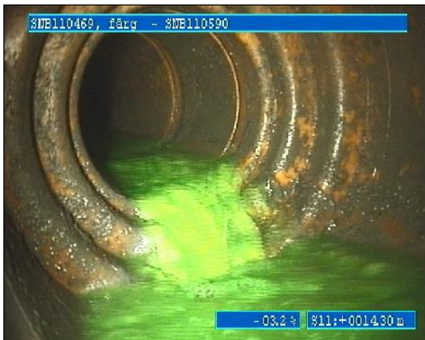
Figur 10. Färgat vatten från felkopplat stuprör vid TV-inspektion i spillvattenledning.
