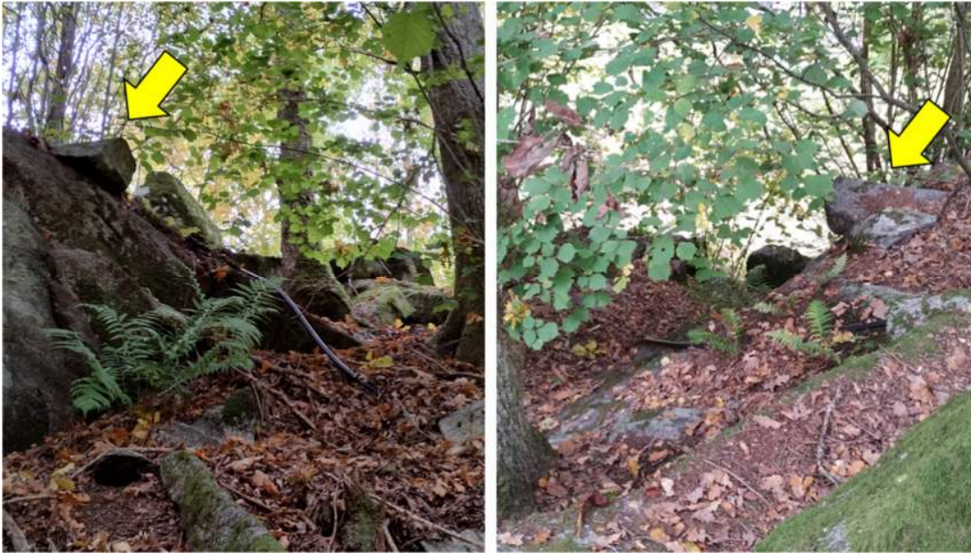
Figur 17. Löst block som hänger ut över slänkrönet. Foto mot nordnordväst. T.v. sett nerifrån, t.h. sett uppifrån. Foto mot syd-sydost
