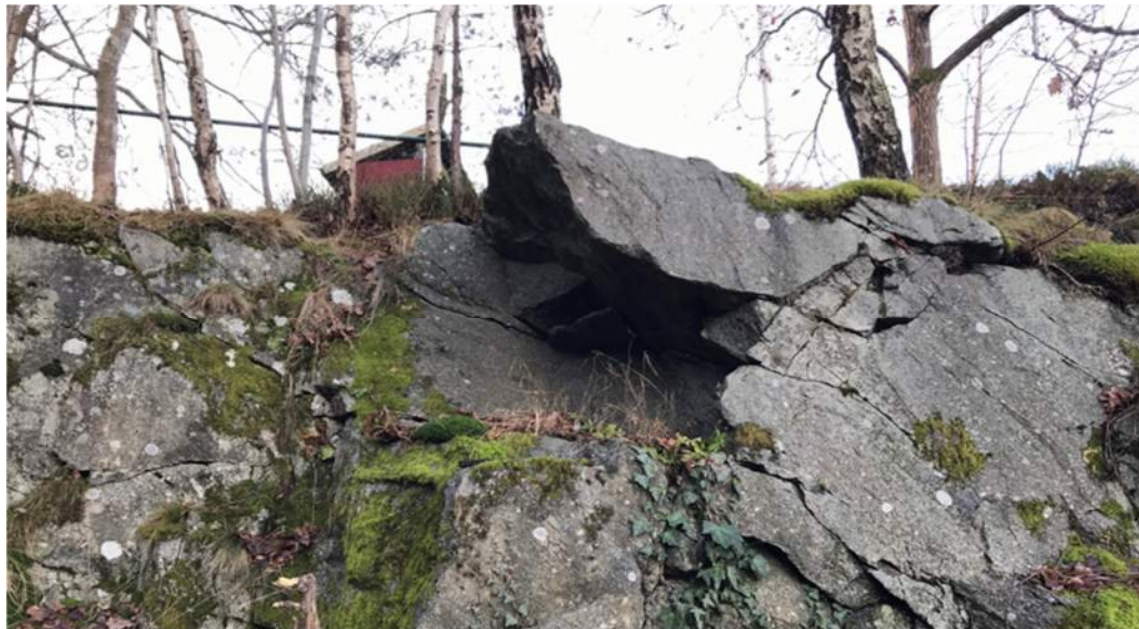
Figur 15. Löst block i parkeringens sydvästra ände, på fastighetsgränsen mot förskolan Viljan.
