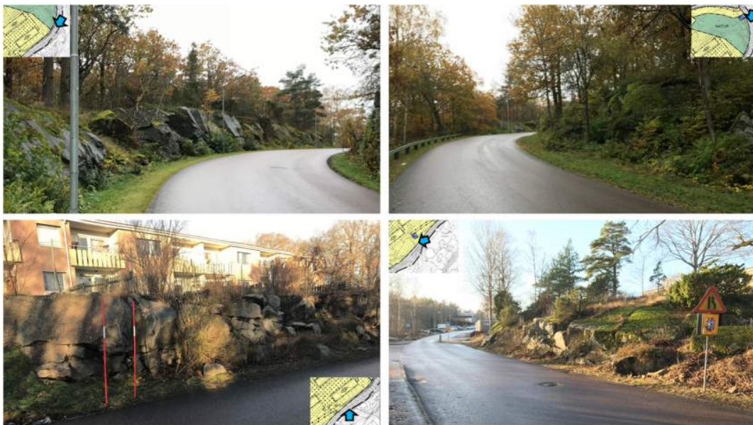
Figur 12. Skärningar längs Hällebergsvägen i Delområde 1. Slänterna har förhöjd uppsprickning p.g.a. sprängskador.
