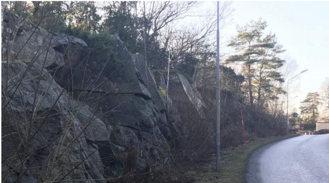
Figur 9. Foto mot syd-sydväst på skärning längs Hällebergsgatan. Skärningens lutning mot nordväst följer bergets brantstående naturliga strukturer.
